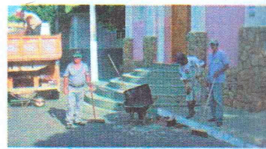
Sr Antonio Marciano, coordenando a operação "tapa buracos" realizada pela Sec. de Obras
