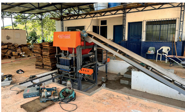
Em outro passo importante, a fábrica de blocos está sendo instalada na antiga Usina de Reciclagem, para fornecer material a algumas obras do município
