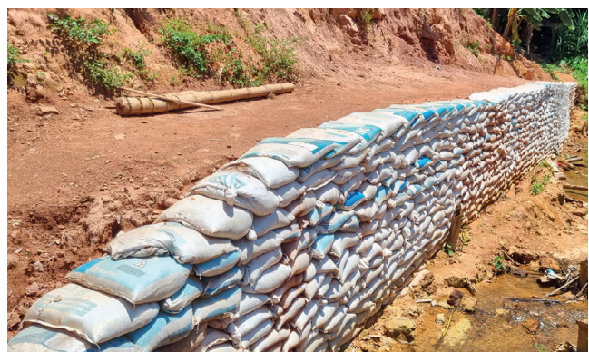
O muro de rip-rap construído na encosta abaixo do Parque de Eventos confirma a preocupação com a segurança em alguns locais específicos
