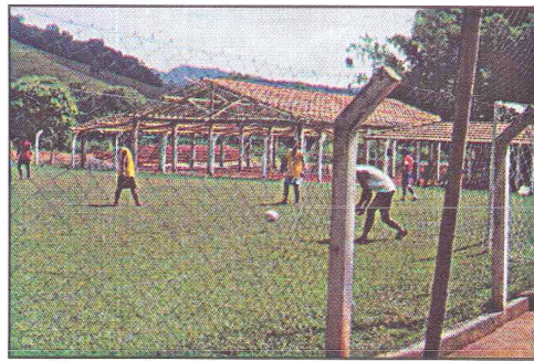
Vista parcial do Sítio do Bananinha, vendo-se a obra de construção do "ranchão".
