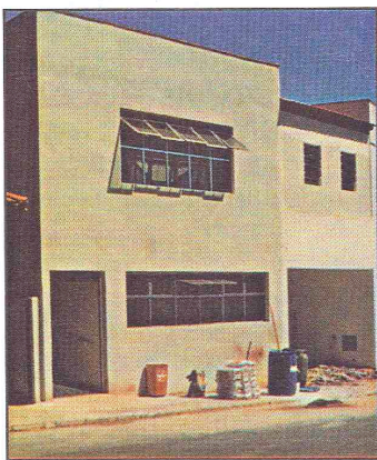
Mão de obra do próprio município, salvo o rebaixamento do teto em gesso, demonstra a capacidade de ser levado adiante uma frente de obras arrojada.
