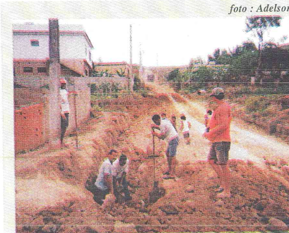
Colocação de manilhas na Travessa Pedro Dutra de Moraes, em continuidade ao projeto de saneamento básico desta Administração
