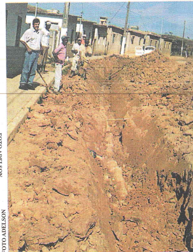
Esgoto na Saracura
